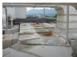
空調機排気ダクト腐食
