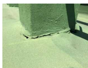
建物屋上防水劣化
