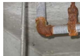
屋内排水管腐食
