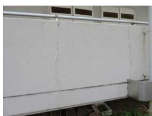
建物外壁クラック
