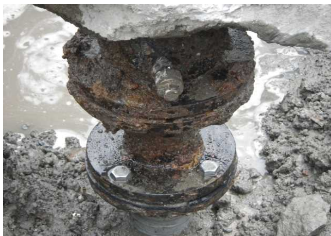
屋外埋設配管腐食
