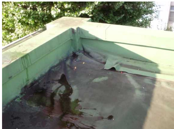
建物屋上防水劣化
