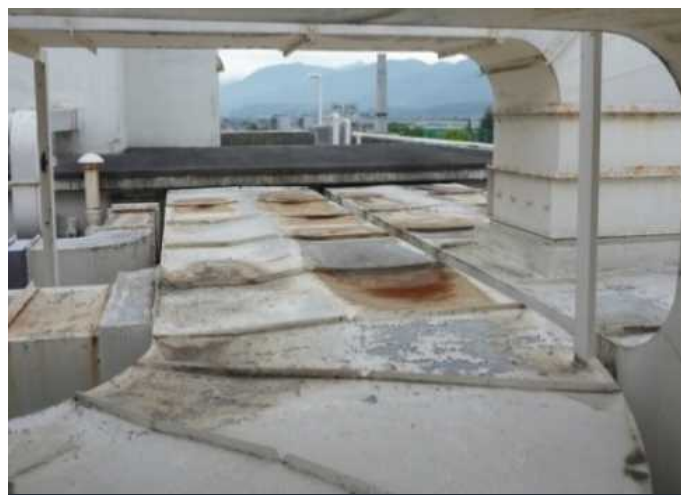
空調機排気ダクト腐食
