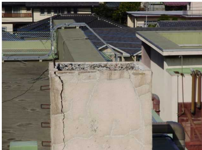
建物外壁クラック
