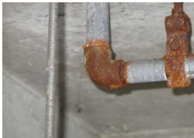
屋内排水管腐食
